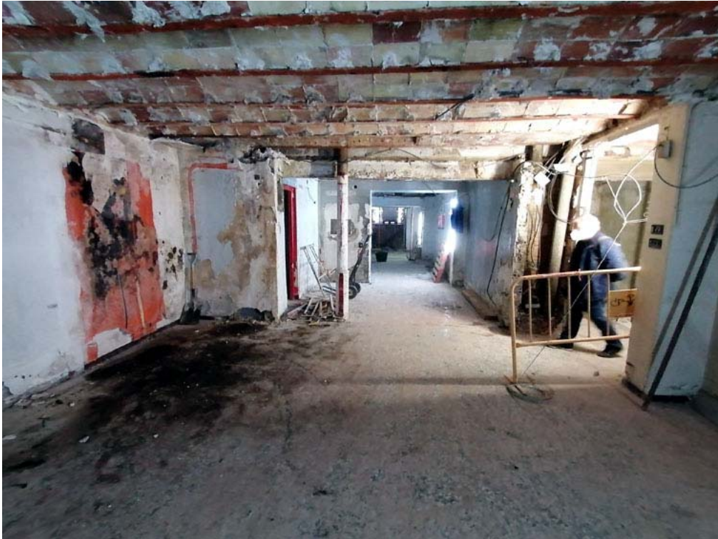
FOTOGRAFIA 11 → Imatge inicial de la zona del darrere del local de la planta baixa, on es va obrir la petita rasa per connectar els baixants pluvials a la conducció d'aigües residuals principal, des del nord.
