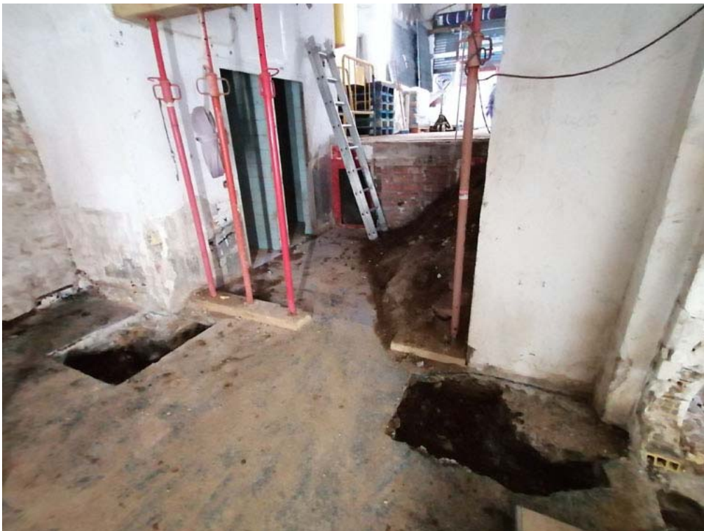
FOTOGRAFIA 14 → Imatge final de les dues cales de comprovació de la fonamentació als baixos de l'immoble, des del nord-oest.
