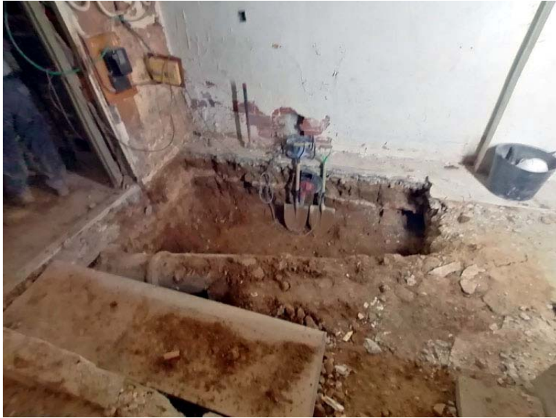
Imatge de l'obertura d'aquesta gran cala quadrangular per construir el fossat de l'ascensor al carrer Nou de la Rambla, 16. (Foto: Òscar Matas).
