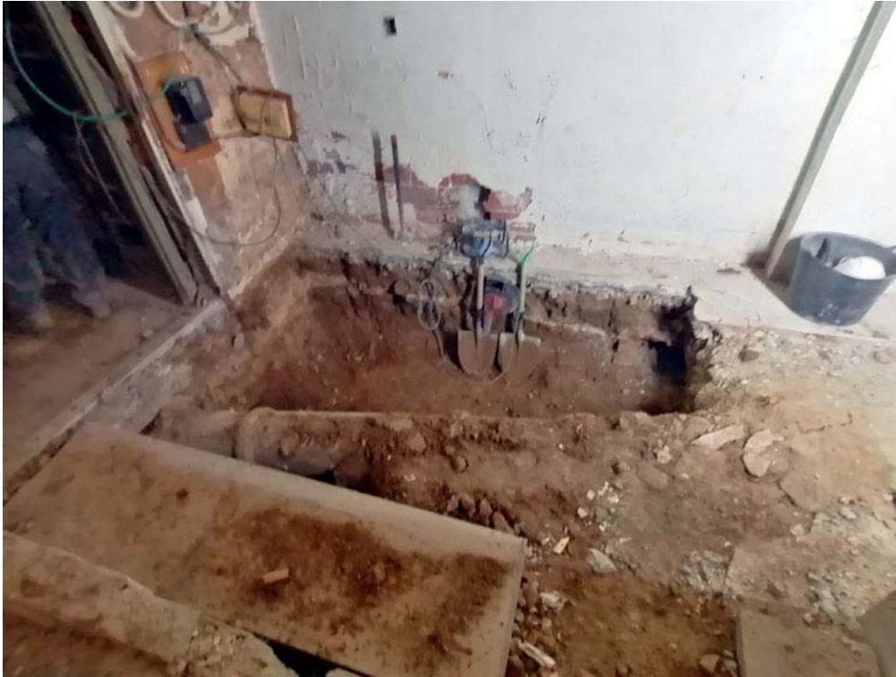
FOTOGRAFIA 4 → Fotografia durant les tasques d'excavació del fossat de l'ascensor, des de l'est.
